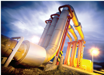
الشكل (٧-٢١): أنابيب نقل النفط.
